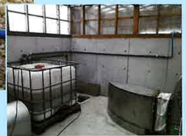
■ 循環水タンク
